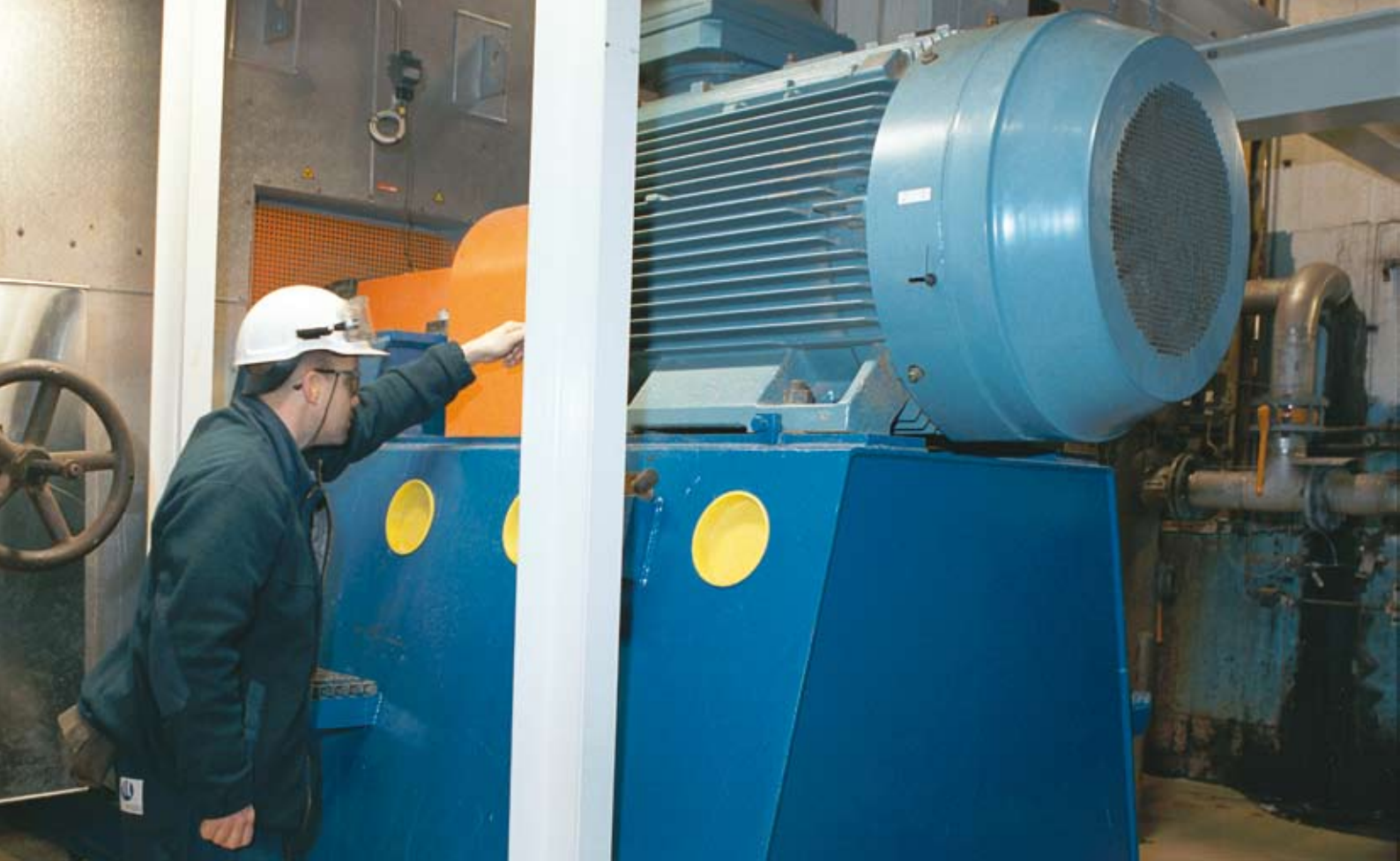
Martin Ljungqvist, arbetsledare på Hydro Polymers elavdelning, kontrollerar en av ångcentralens rökgasfläktar som styrs av Emotron frekvensomriktare.
